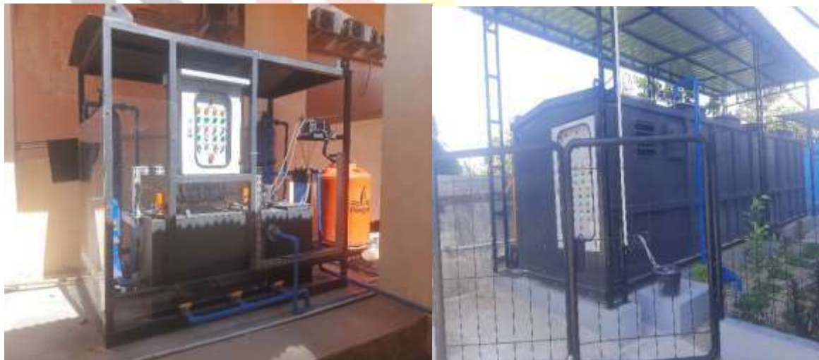
Gambar 12 Instalasi Pengolahan Air Limbah (IPAL)
