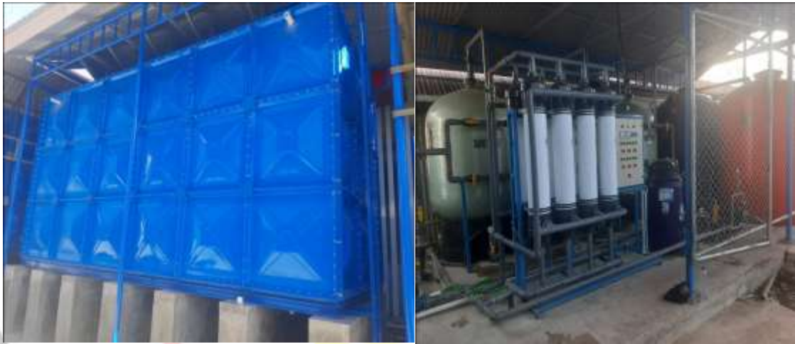
Gambar 13 Instalasi Air Bersih (WTP)
